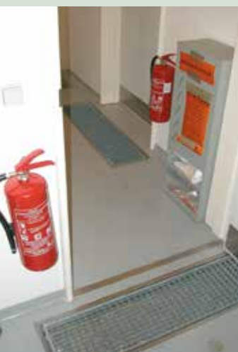
Slukningsudstyr og spildopsamlingsmateriale ved oplag af brandfarlige væsker
