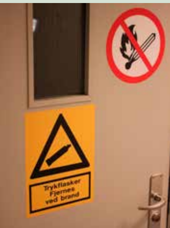
Lokaler, hvor der opstilles trykflasker, skal forsynes med advarselsskilt
