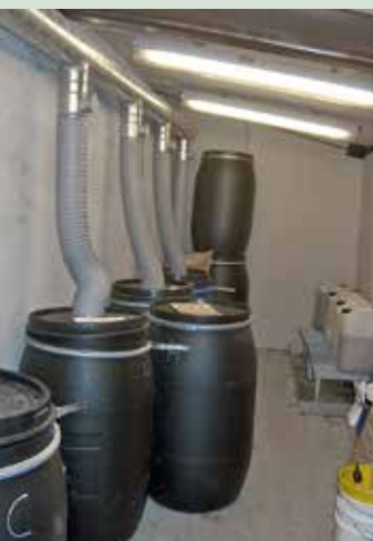
Ventilation i rum til kemikalieaffald
