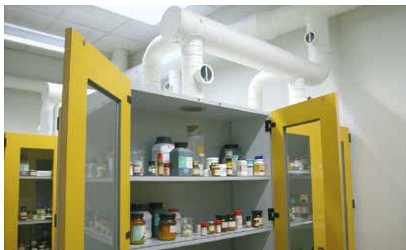
Kemikalier skal normalt opbevares under ventilerede forhold
